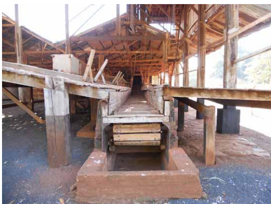
Tanques de água, mesa alimentadora e esteira rolante do engenho
