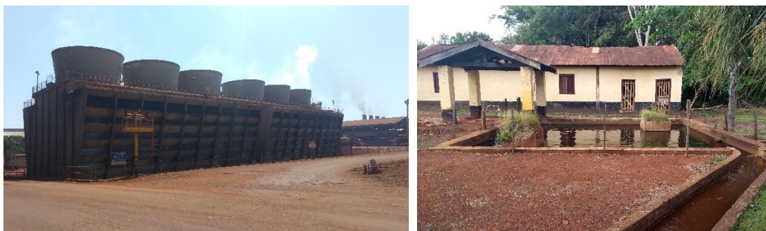
Figura 88- Decantadores de água da Usina Santa Elisa, estrutura de concreto armado que realiza o resfriamento e limpeza da água para equilíbrio do PH. Fonte: Camila Paulucci, 2017.
